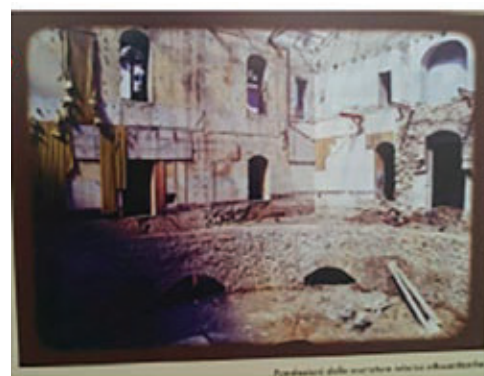
Figg. 1 e 2 Lo stato della fabbrica conseguente le demolizioni avvenute a metà del Novecento per dar posto alla sala del "Cinema Teatro Cosmo", a sua volta dismesso a metà degli anni Settanta: appare la completa perdita delle strutture interne del teatro ottocentesco, del quale permangono le fondazioni a "ferro di cavallo" e le murature d'ambito.
