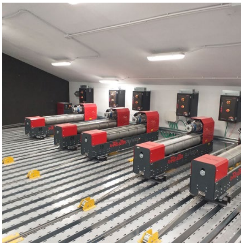
Fig. 8 Il piano graticciato con i gruppi elettromeccanici di sollevamento.
