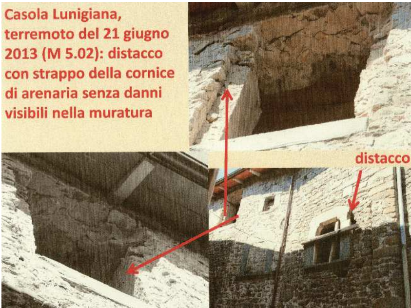
Fig. 4 Casola Lunigiana, distacco delle cornici delle finestre senza danno al corpo dell'edificio (terremoto del 21 giugno 2013, M Richter 5.2).
