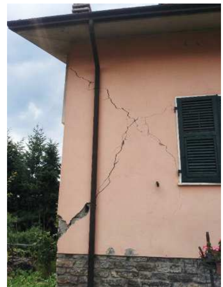
Fig. 27 Fivizzano, edificio costruito nel 1980 con criteri sismici e dichiarato inagibile.
