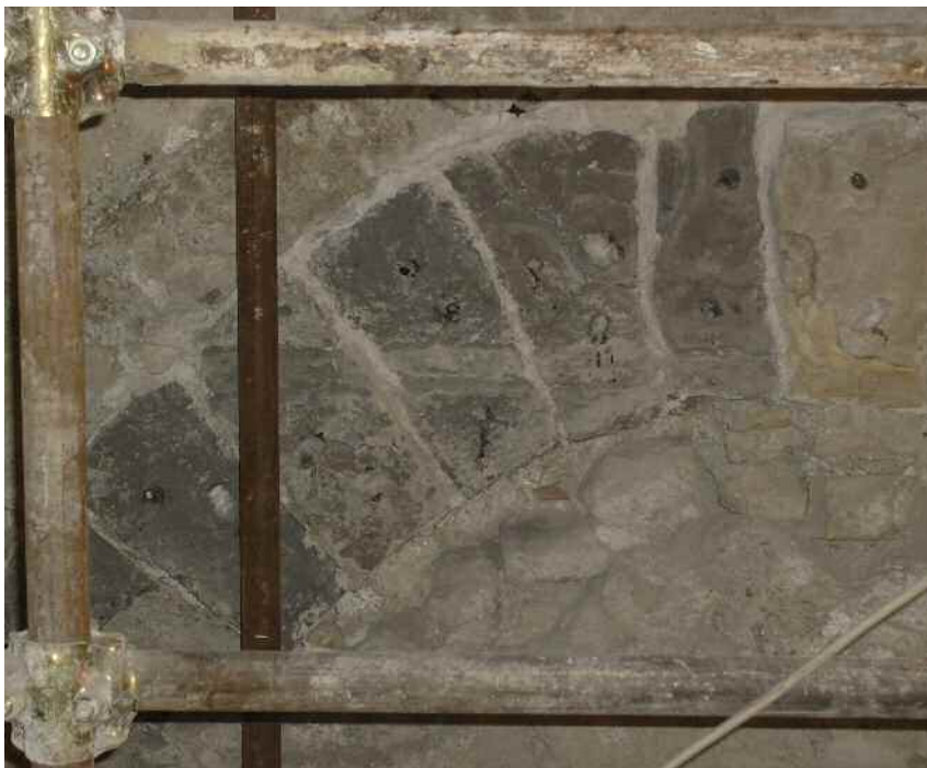
Fig. 5 Chiesa di S. Salvatore de' Birecto ad Atrani. Esempio di restauro in atto di arco con rinforzi di tufo grigio e malta (fonte Luciano Russo)
