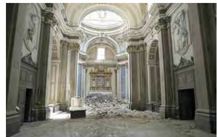
L'Aquila, Chiesa delle Anime Sante dopo il sisma, interno
