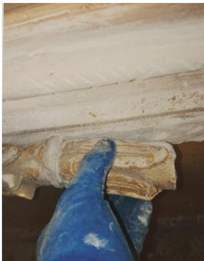
Fig. 25, 26 Imperniazioni e fissaggi di elementi di modellato a rischio di distacco e caduta.
