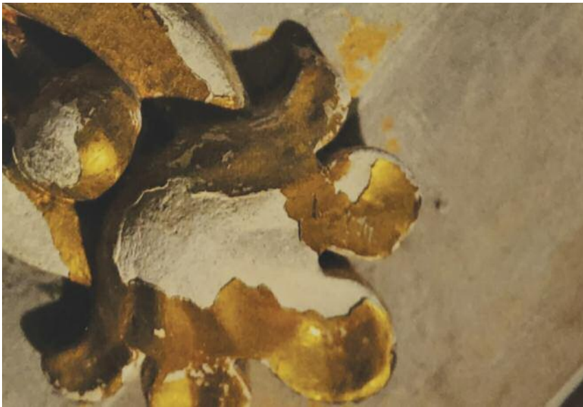
Fig. 14 Distacco della doratura per difetti di adesione al supporto.
