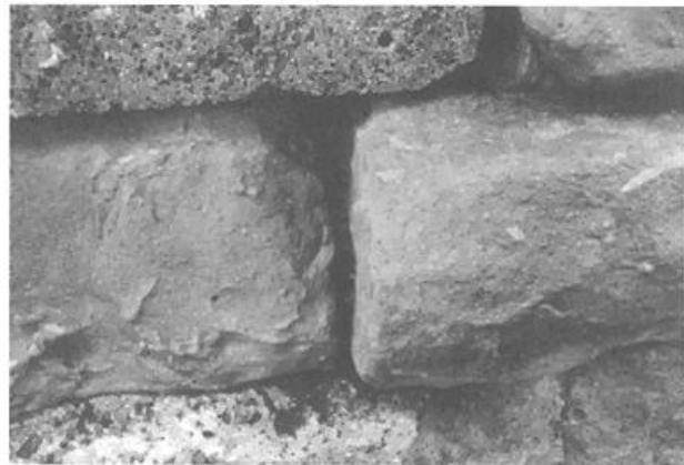
Fig. 10. Tempio di Cerere, erosioni dell'arenaria sul frontone del tempio.
