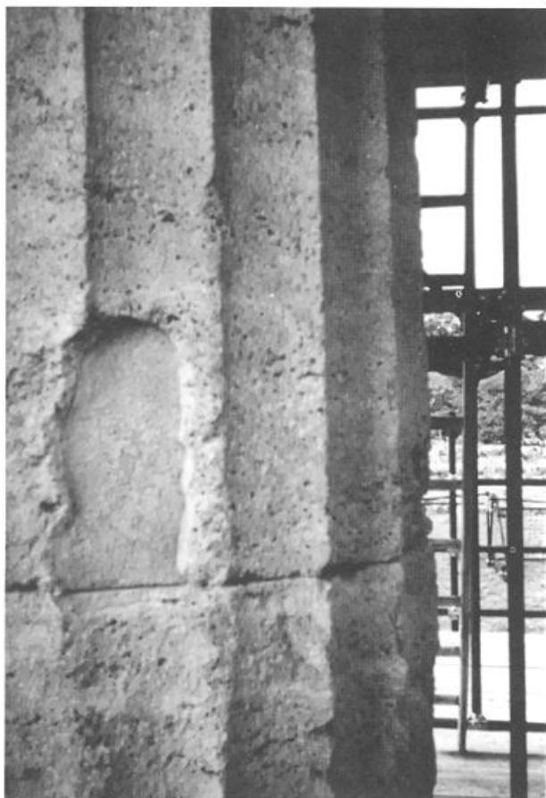
Fig. 8. Tempio di Cerere, stuccatura dei grandi fori e discontinuità della pietra.
