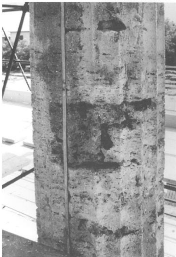
Fig. 4. Tempio di Cerere, sferzatura di una colonna con le alterazioni caratteristiche.
