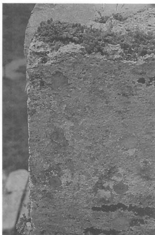
Fig. 4. Particolari delle impernature. Testata della pietra d'angolo. Si osservano numerose stuccature in cemento che sigillano superficialmente i fori longitudinali.
