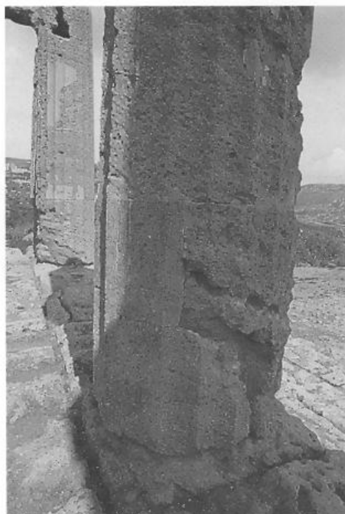
Fig. 13. Esempi di risarcitura con argilla espansa e sostanze coloranti; interventi privi di efficacia statica.
