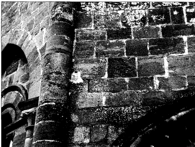
14. - Detalle de la portada principal de la iglesia de Santa María de Eunate (Navarra), en la que se aprecian las lesiones que ha sufrido este sector del edificio.
