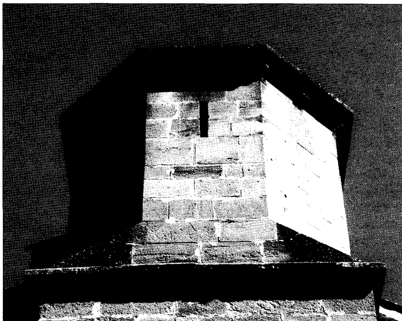
15. - Remate del torreón poligonal de escaleras de la iglesia de Santa María de Eunate (Navarra) añadido en el curso de las restauraciones de los años cuarenta.
